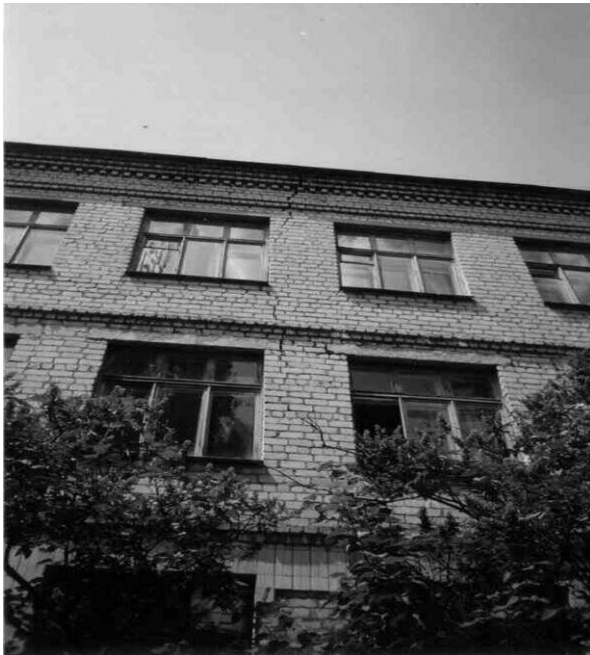
Рис. 1 - Пошкодження зовнішніх стін будівлі середньої школи № 40 по вул. Сестроріцькій, розміщеної на кордоні охоронної зони кар'єра ВАТ «ПівнГЗК».
