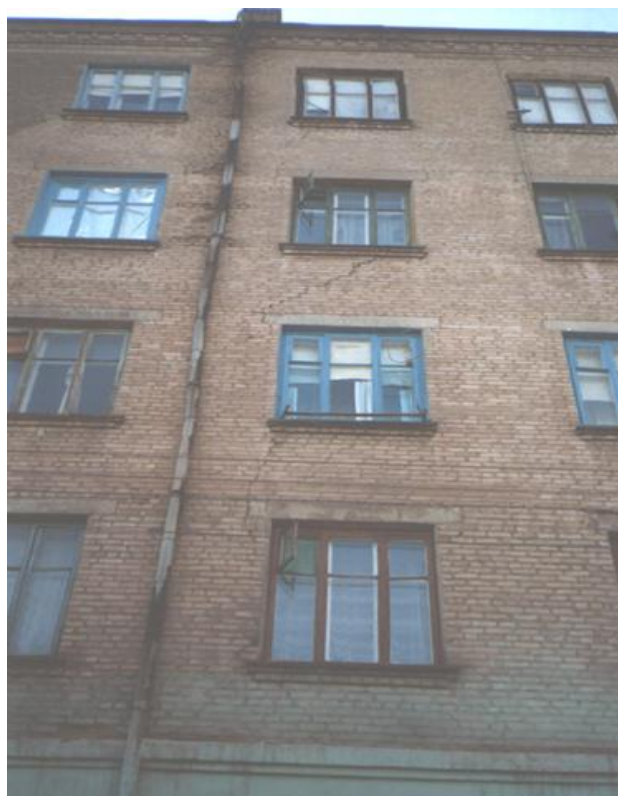
Рис. 10 – Похилі тріщини в підвіконній частині стіни житлового будинку по вул. Кремлівській, 13
