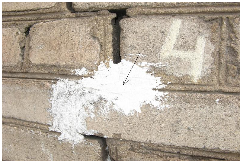
Рис. 18. – Утворення тріщин в стіні будівлі Центру творчості після вибуху 10.08.09.
