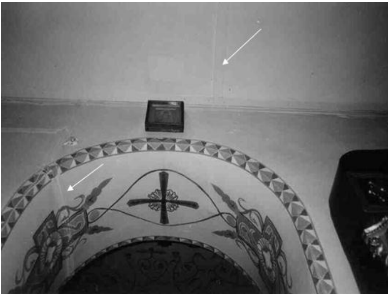
Рис. 6. – Вертикальні тріщини в стіні Церкви Різдва Богородиці по вул. Обручева, 14
