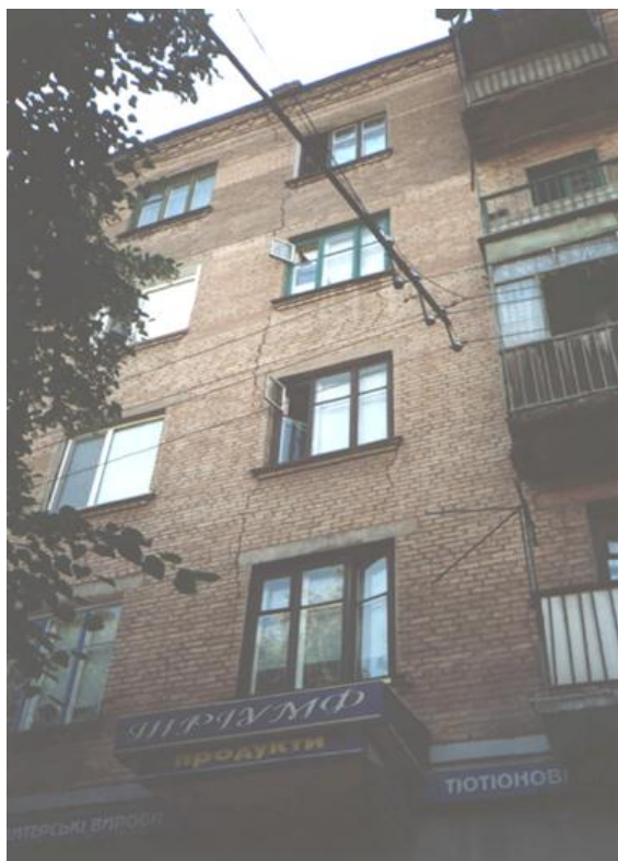
Рис. 9 – Вертикальні тріщини в стіні житлового будинку по вул. Кремлівській, 13
